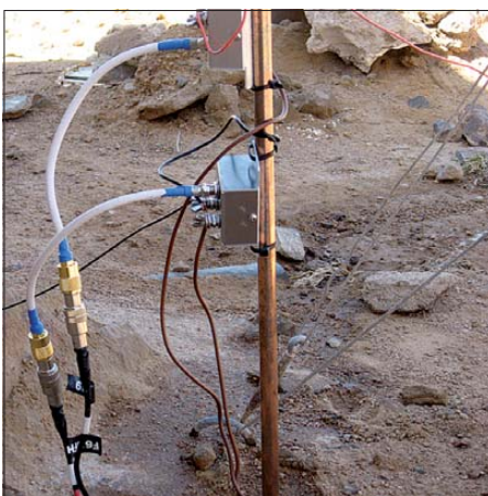
Einspeisung der Beverage-Antennen für 160 m
