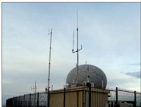
Technikcontainer mit Antennenanlage von DB0WK auf der Wasserkuppe in der Rhön Foto: DG7FBS
